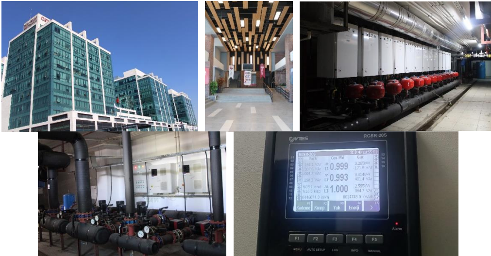
Resim-1.a-e : OSTİM Teknik Üniversitesi binası elektrik ve mekanik donatıları.
