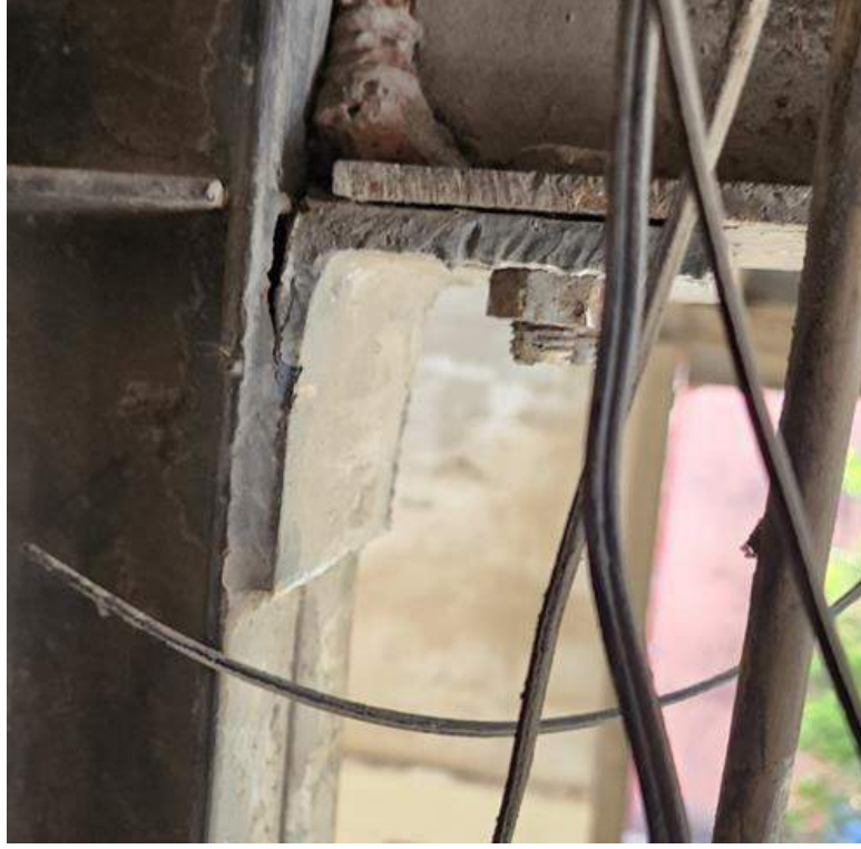
Şekil.4 Deprem Etkisinde Meydana Gelen Çatlak
